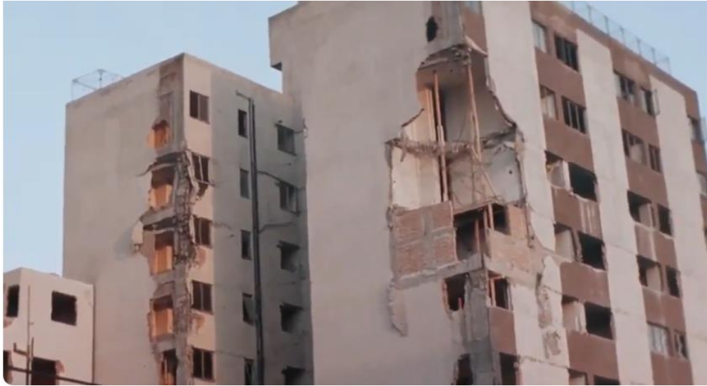
Fotograma. Edificios afectados por el sismo. Lola (1989).
